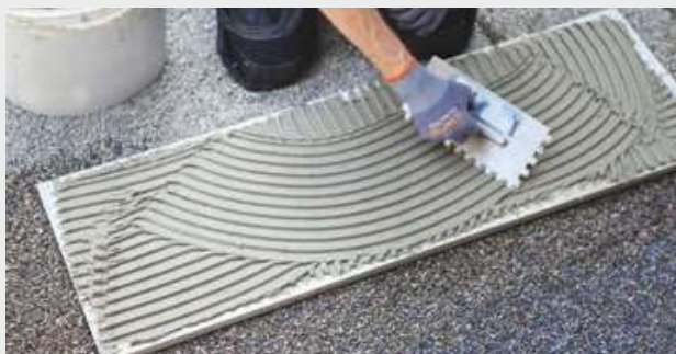
3 PCI Flexmörtel ® Premium rückseitig aufziehen und Platte frisch in frisch in den Drainagemörtel einlegen
