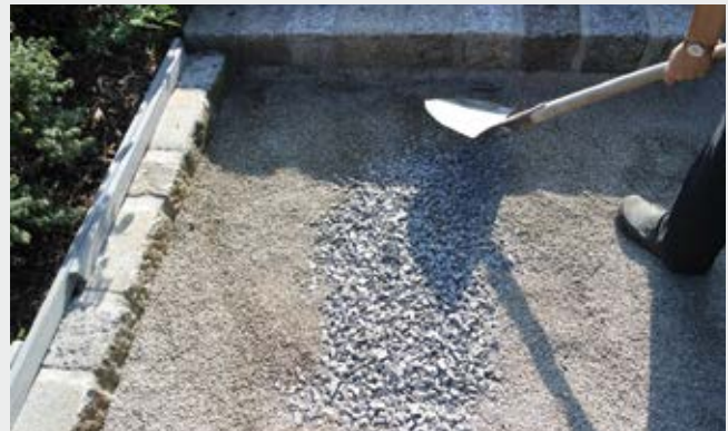
Abb. 4 – Verdichten einer Frostschutz-Tragschicht durch händisches Anklopfen mit einer Schaufel ist unzureichend und nicht wirklich verdichtend .
