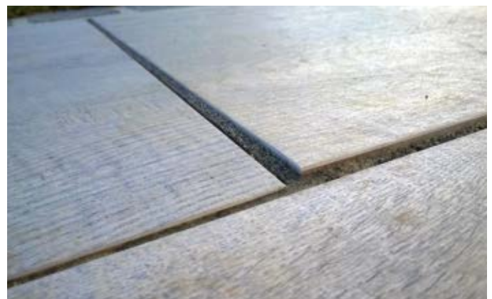
Abb. 10+11 – Nachteil lose Verlegung: Schubkräfte der Platten führen zu Aufkantungen und Verschiebungen von Platten trotz anbetonierter Pflaster-Randbefassung zementär verfugt.
