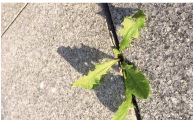
Abb. 19+20 – Beispiele von Terrassen mit nicht verschlossenen Fugenzwischenräumen.
