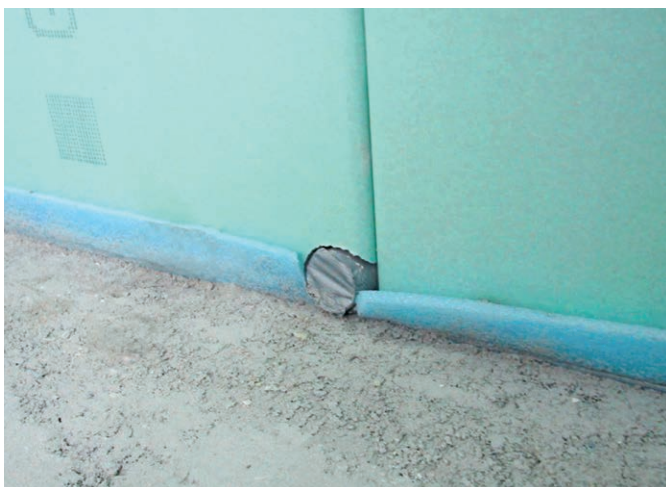
Abb. 2 – Hier liegt das Abflussrohr DN 50 auf der Oberkante des Estrichs auf. Das Herstellen einer Verbundabdichtung ist somit nicht möglich.
