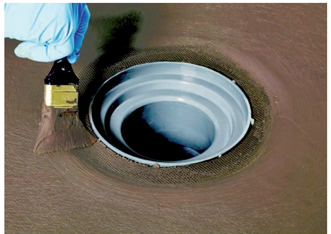
Abb. 8 – Kessel Bodenablauf und Auftrag von PCI Seccoral® inkl. Einbau von Gewebe. Der Klebeflansch ist vorab, je nach Wasserbeanspruchung, mit einer Haftgrundierung (Privatbereich mit PCI Gisogrund® 303/ im öffentlichen Bereich mit PCI Epoxigrund 390 inkl. Abstreuerung mit Quarzsand, Körnung 0,3 bis 0,8 mm) zu versehen.
