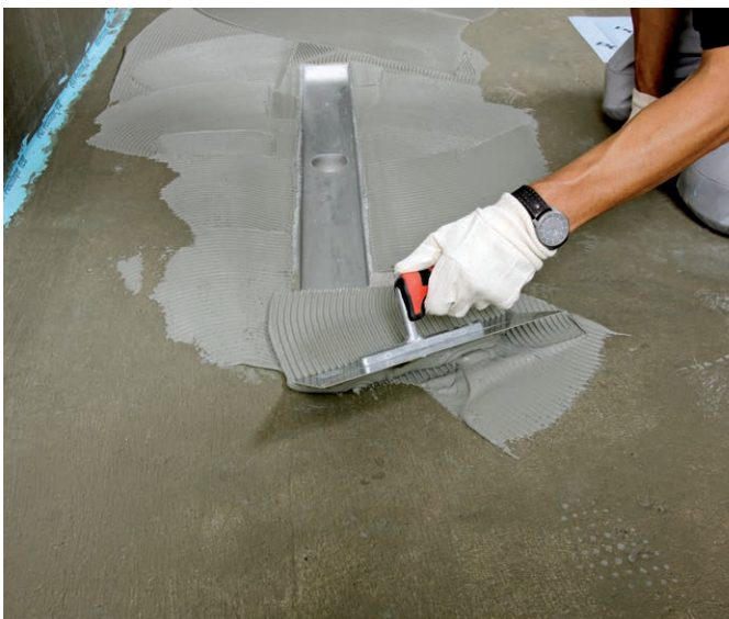
Abb. 15 – Schritt 5 – Nach 12 Stunden Aushärtezeit: Grundierung der Gesamtfläche und erster Auftrag der Verbundabdichtung PCI Seccoral®.
