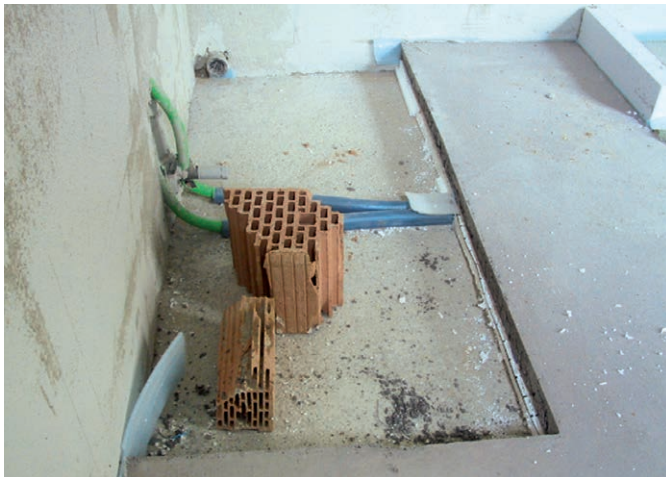
Abb. 1 – Badezimmer im privaten Bereich mit Wannenausparung.
